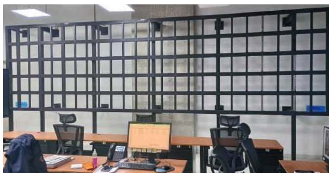
Estructura metálica para los monitores de el CEGES. Fuente: Secretaría de Seguridad y Convivencia
